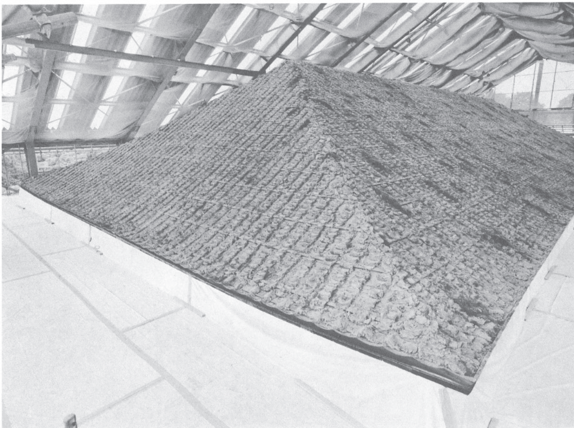
78 南面及び東面の平瓦葺土の状況 東南より見る。東面にも営巢の跡が多く見られた。南面は比較的健全であった。
