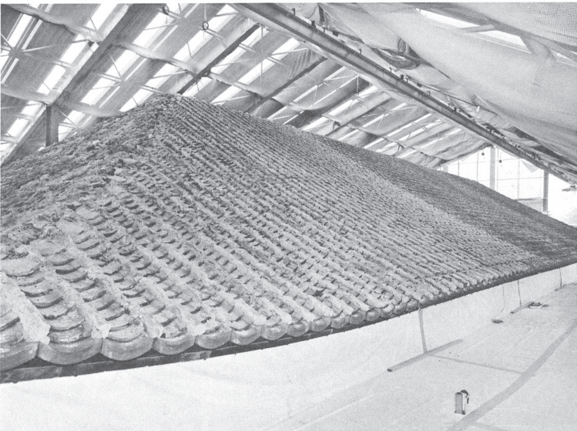
72 西面の丸瓦葺土の状況 西北より見る。西面の南側と北側で葺土が変わっている様子が見られた。北方の白っぽい土は大正十年の修理のものである。
