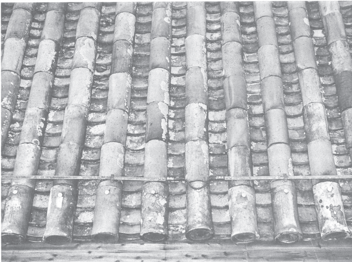
54 修理前本瓦葺東面軒先詳細 東面軒先の修理前本瓦葺を東より見る。
