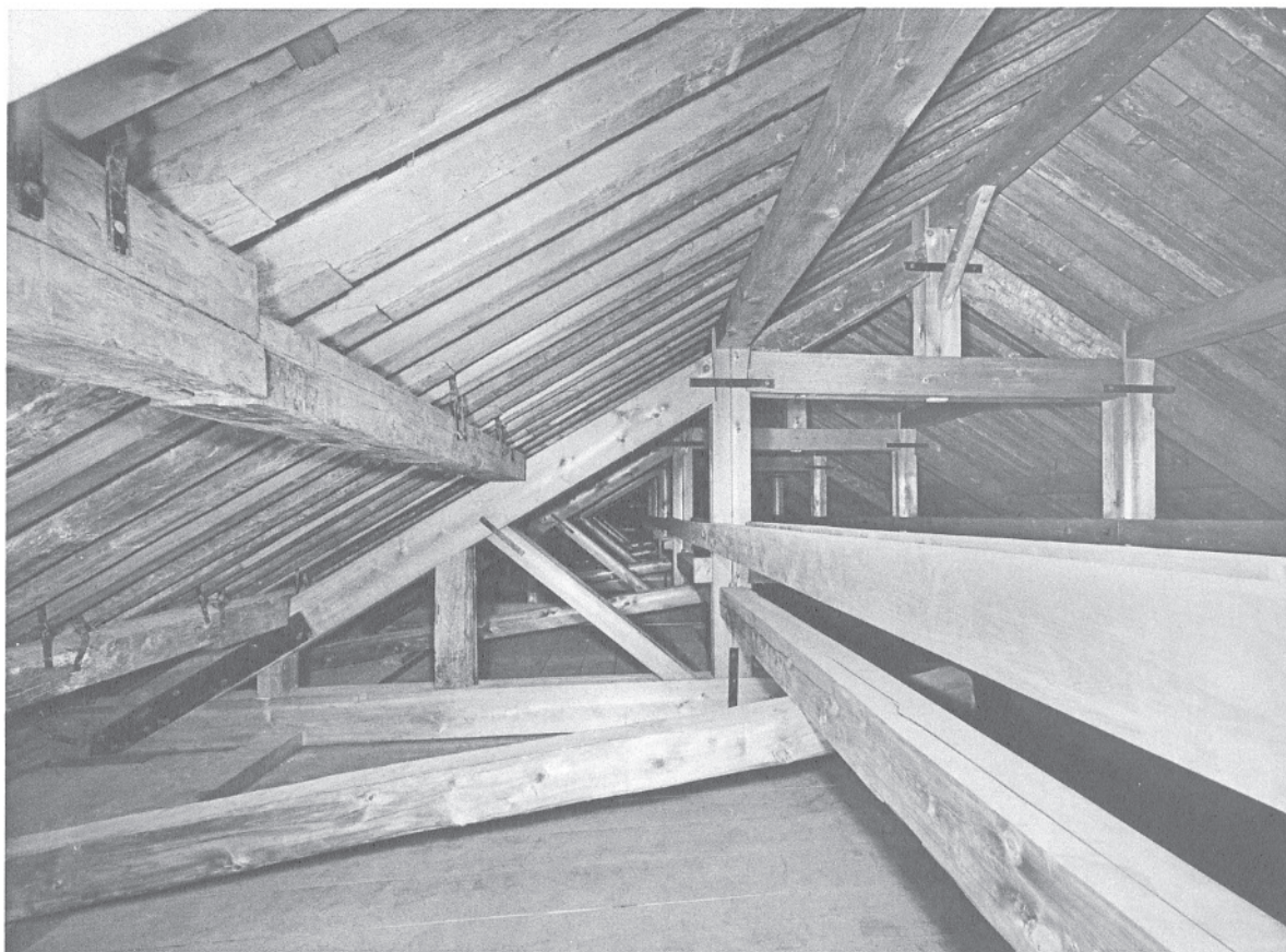
44 修理前小屋組トラス軒部詳細 トラスの先端部分。斜材が交点に入っておらず、トラスとしての役割が発揮されていない。手前は大正修理で入れた枯木。
