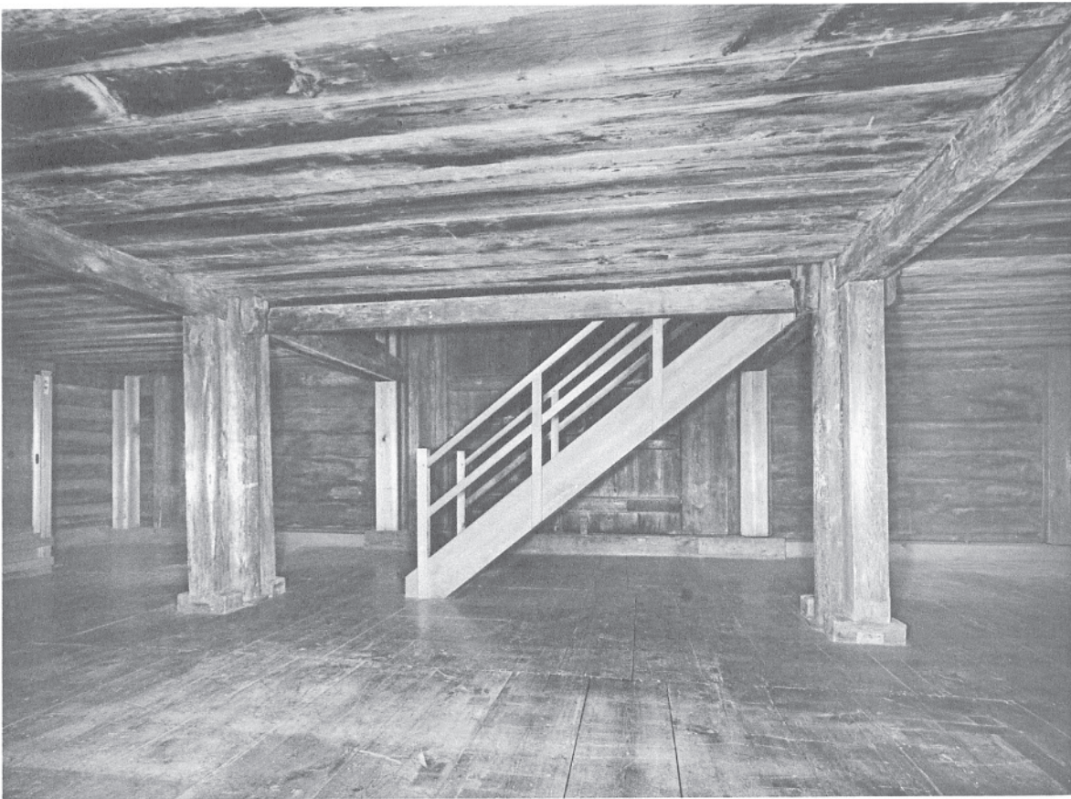
35 修理前中倉内部一階東面 西より見る。二階へ上る階段と扉内側が見える。階段は大正修理後のものである。
