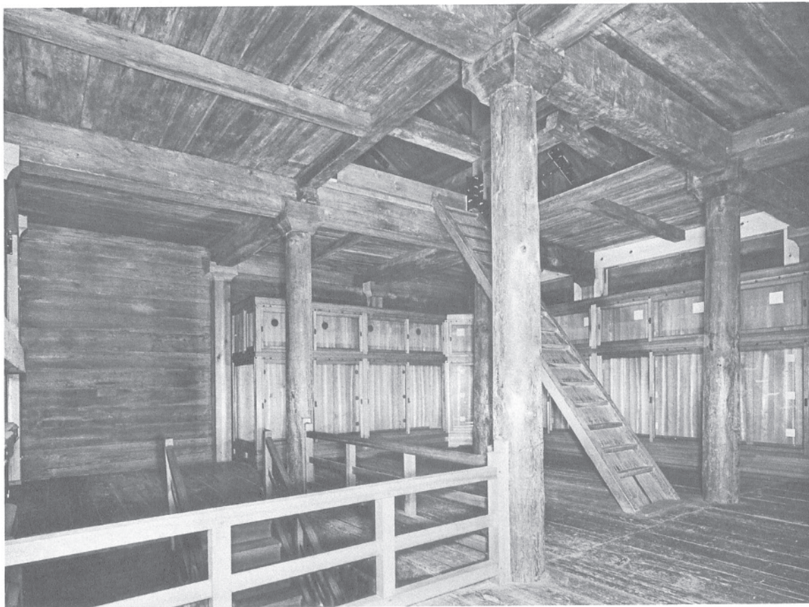
18 竣工北倉内部二階南面及び西面 東北より見る。西面には敷桁受け材と補強の支持柱が見える。中倉境となる南面には敷桁がないため、補強材は入らない。
