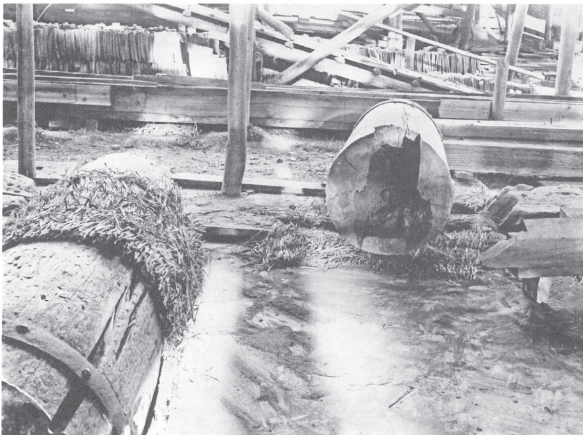
188 大正修理時の南倉東側東柱上部の腐朽状況 「第三五号 宝庫南倉東側柱上部中央朽損ヲ見タル現況」。東柱と頭貫との仕口部分が腐朽している状況が見える。
