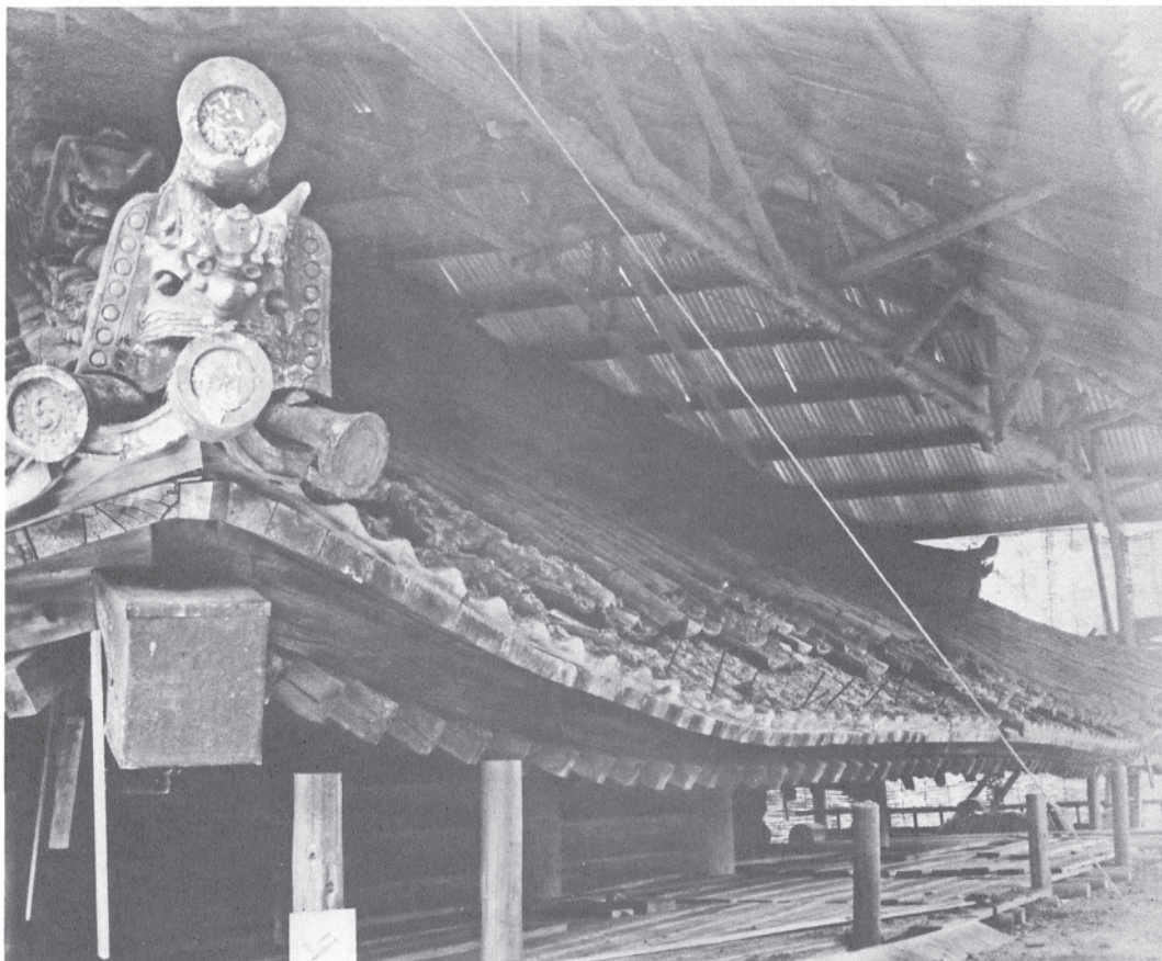
168 大正修理時瓦解体中の北面軒先の状態 「第一五号 宝庫北側軒先廻りノ狂タル現況」。北面の軒は、中央がやや上がりその両端が下がるという状況にあったことがわかる。
