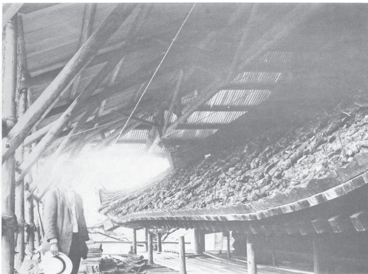
171 大正修理時瓦解体中の南面軒先の状態 「第一八号 宝庫南側軒先廻ノ狂タル現況」。東から見た南面の軒。北面と似たような破損状況が見られる。
