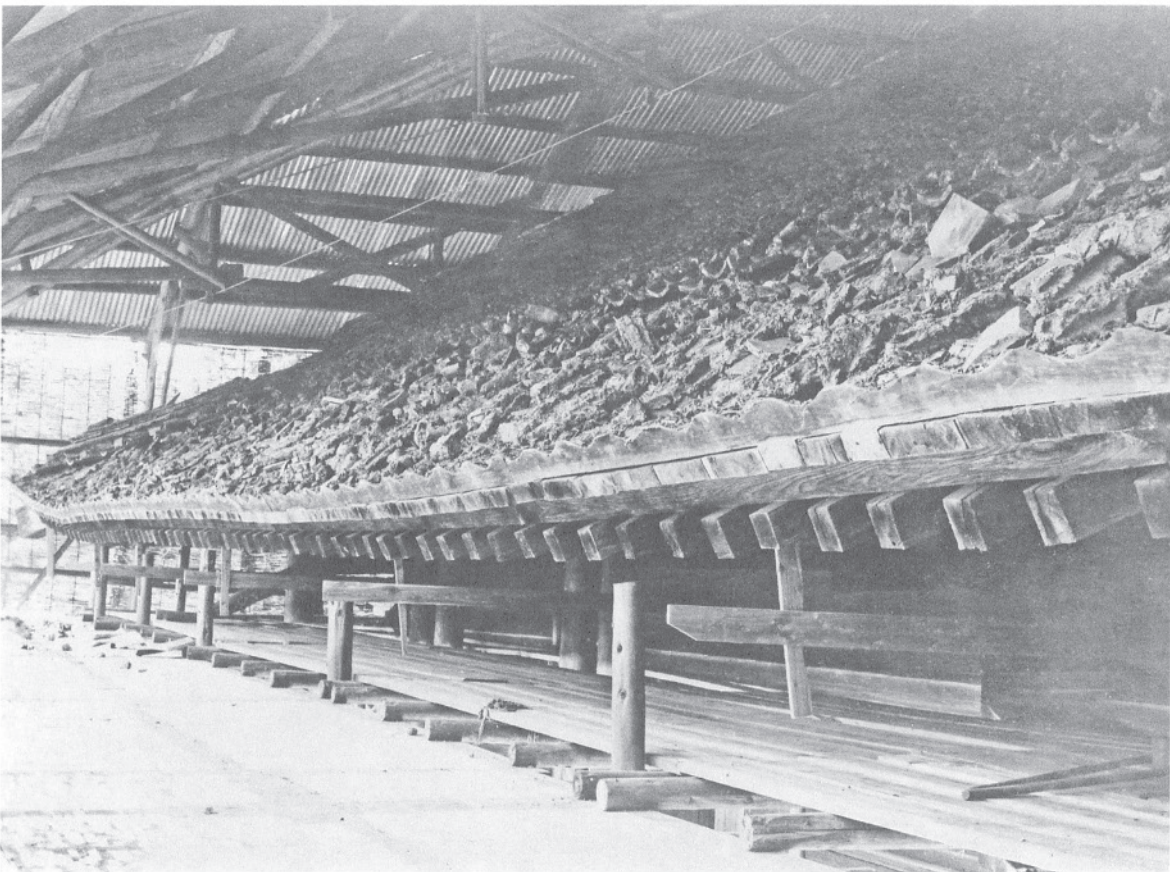
170 大正修理時瓦解体中の東面南方の軒先の状態 「第一七号 宝庫東側軒先廻ノ狂タル現況（南方）」。経年による軒先の乱れが見られる。
