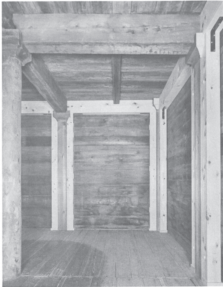
145 南倉での敷桁補強の詳細 南倉南面西端間を北より見たところ。
