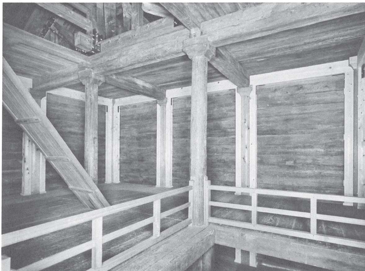
144 敷桁補強後の北倉二階北面及び西面 東南より見る。取り替えた小屋裏の補強金具も見える。
