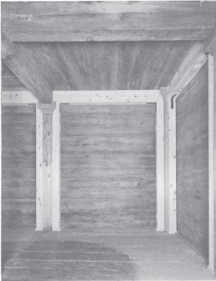
146 北倉での敷桁補強の詳細 北倉西面北端間を東より見たところ。
