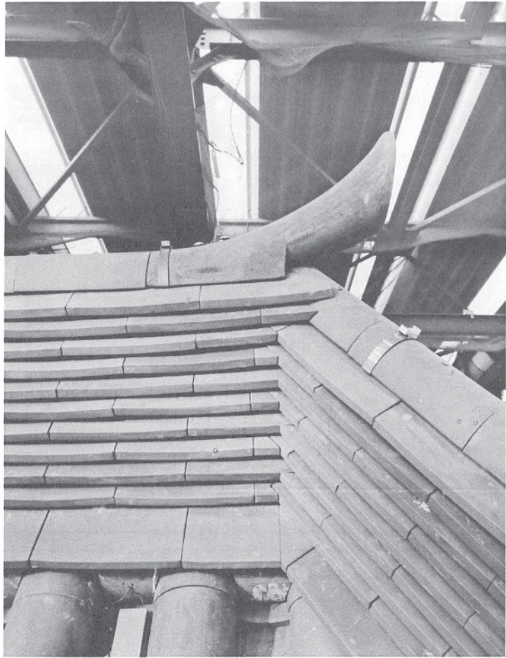
135 大棟棟積完了北端 東より見る。鳥衾瓦は大正十年のものを を再用し、鬩斗瓦及び丸雁振瓦はすべて 取り替えた。
