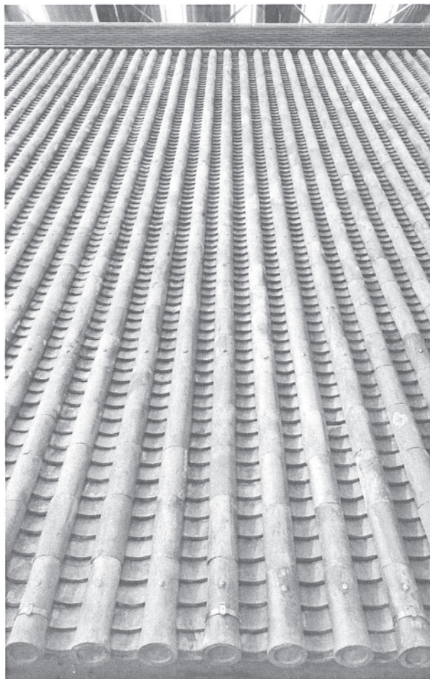
131 東面の本瓦葺き上がり 東面中央部を東より見る。江戸時代の 再用瓦を中心に葺いた部分。修理前に 倣い丸瓦は5本に1本を釘止めた。 軒丸瓦の3本に1本取り付いているの は、避雷導体の固定用金具である。
