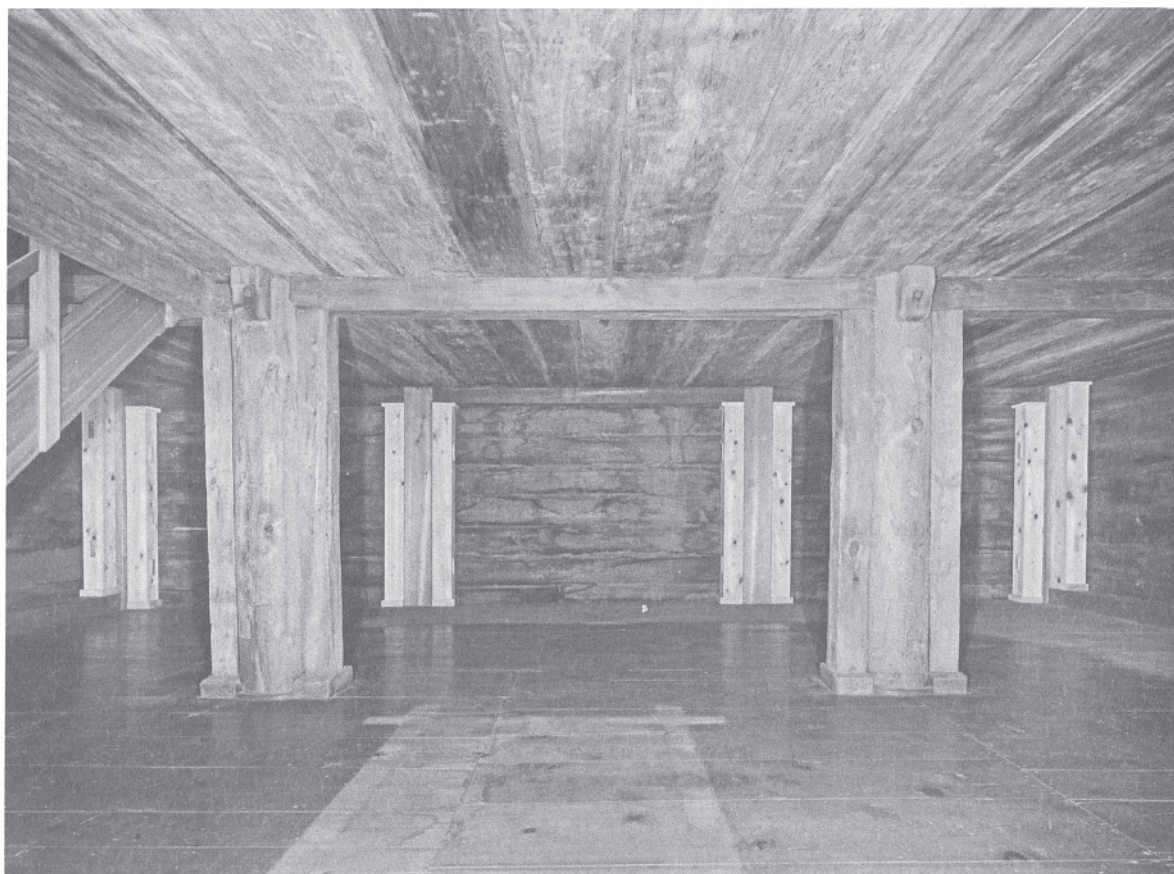
138 敷桁補強後の南倉一階南面
