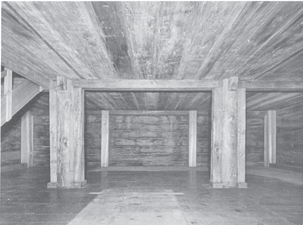
88 ガラス戸付陳列棚解体後の南倉一階南面 北より見る。奥に見える壁際の内部柱は大正修理時の材である。校木に雨染みが見える。
