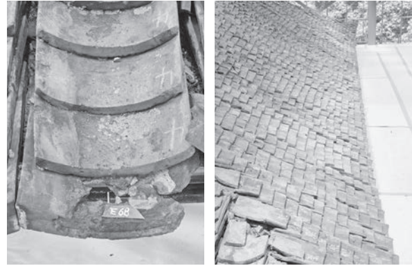
図128 軒平瓦の凍て割れ 図127 平瓦の乱れ(北面)(東面)
