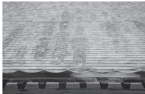
図130 瓦座及び土居葺の腐朽(西面)
