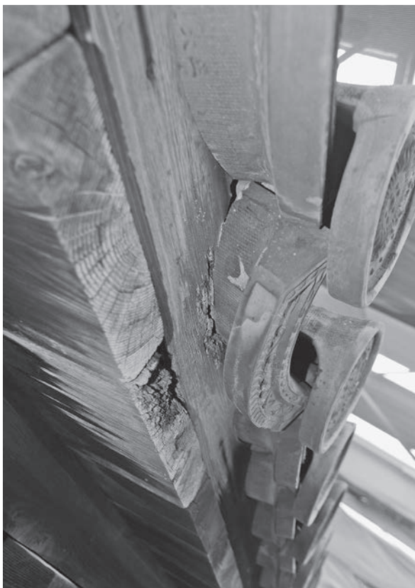
図126 軒平瓦の割れによる切裏甲・瓦座の腐朽
