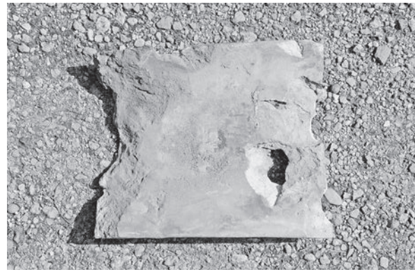
図129 平瓦の凍て割れ
