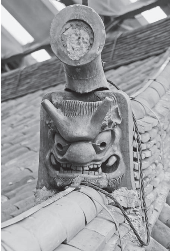
図132 東北二の鬼瓦足の状況と鳥衾瓦瓦当の破損
