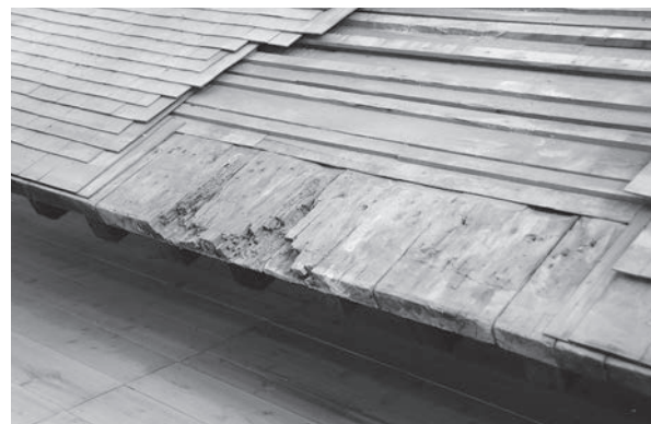
図131 切裏甲の腐朽(西面)
