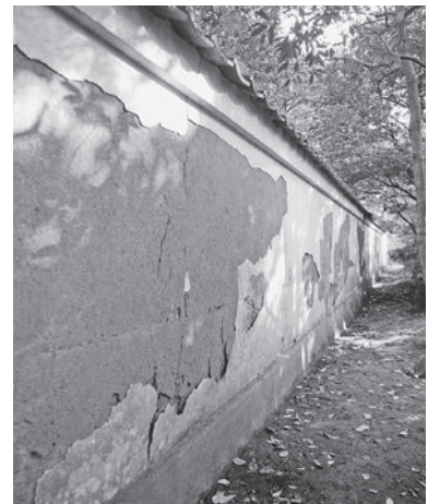
図272 漆喰の剥落(北土塀南面)
