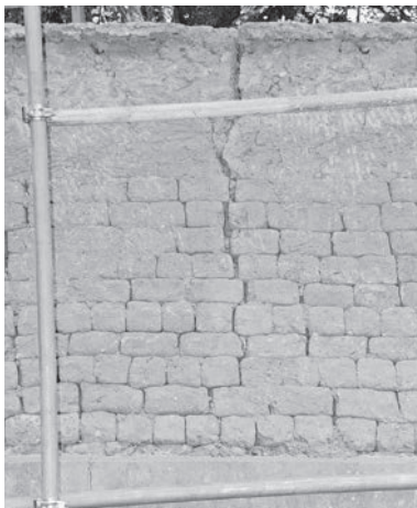
図274 土塀躯体からの割れ(北土塀)
