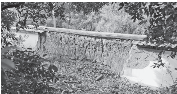
図276 瓦と壁面の大規模な崩落(西土塀東面)
