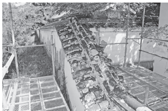
図255 袖塀の屋根の破損状況
