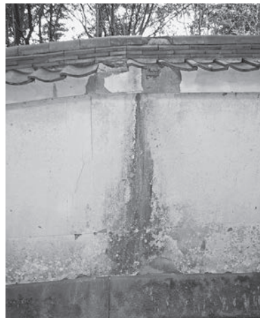
図273 瓦の割れと漆喰の汚損(北土塀)
