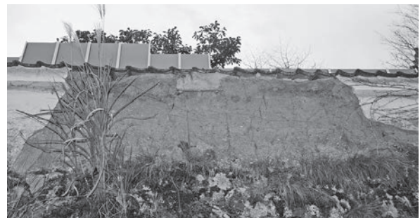
図275 壁面の大規模な崩落(西宝庫北側土塀)
