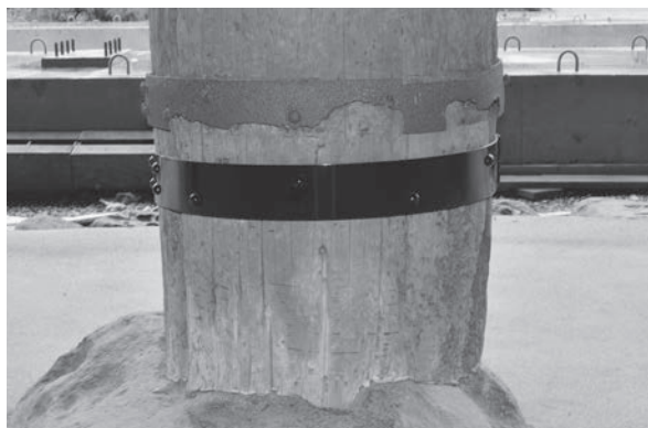
図227 元禄期の箍の破損と追加した箍の状況
