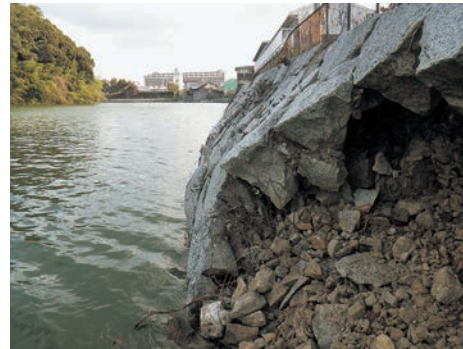
図3 石積崩落状況
