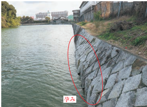
図2 石積孕み状況
