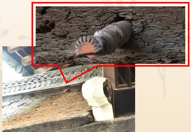
露台屋根 ドレンチャー
