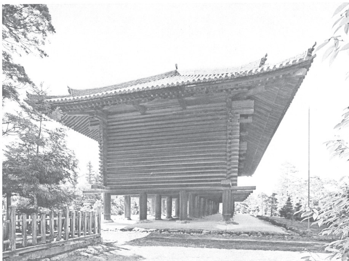
26 修理前正倉側面（北面） 杉本神社の西側から見た北面の修理前の状況。
