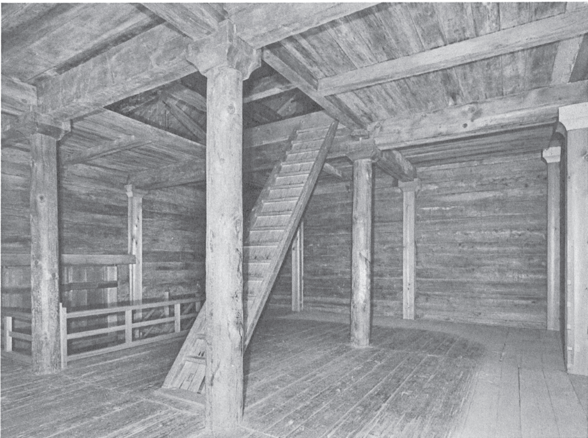
102 ガラス戸付陳列棚解体後の北倉二階南面及び東面 西北より見る。北倉大梁から中倉側にかかる妻梁の様子がよくわかる。
