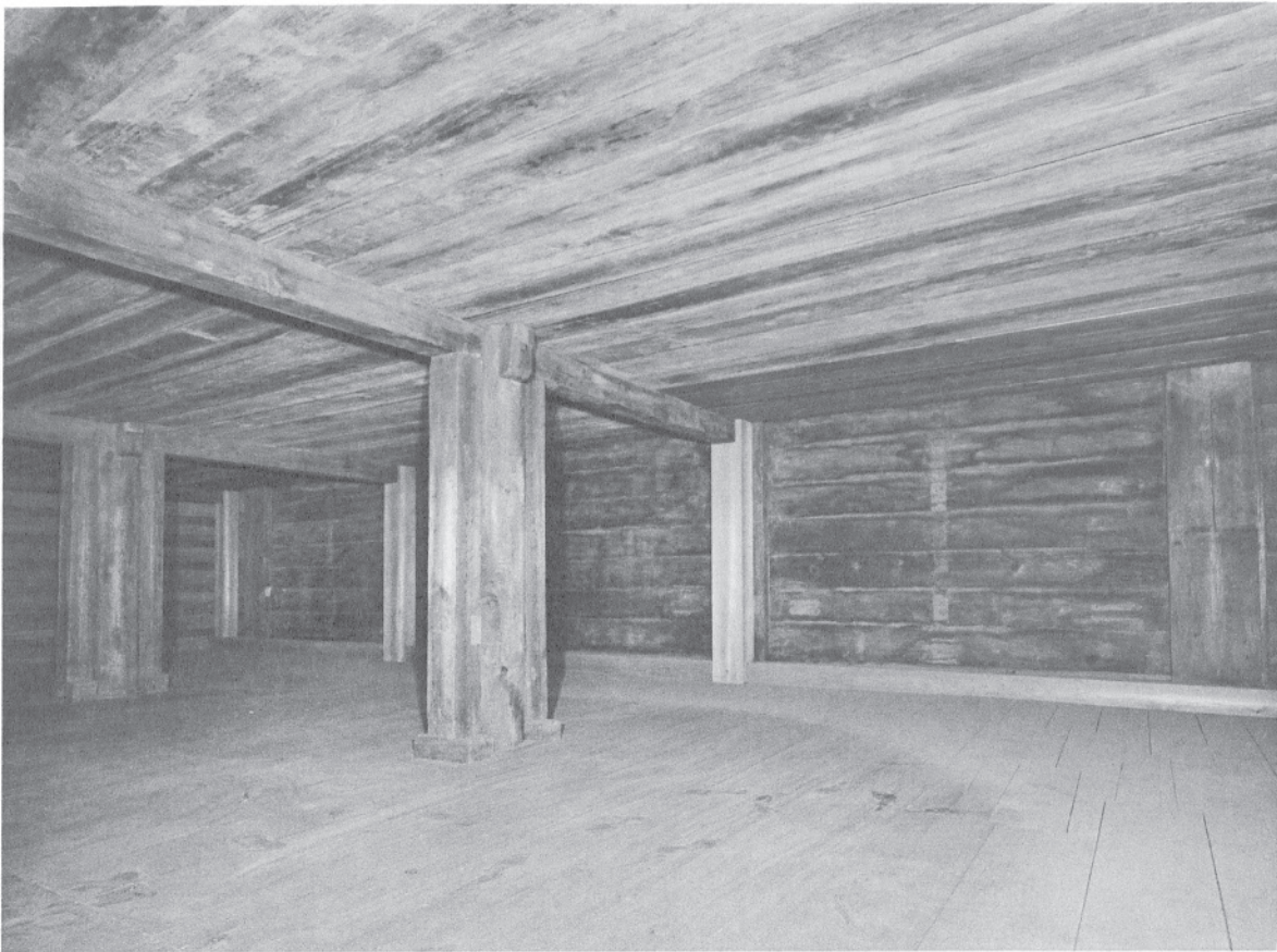
95 ガラス戸付陳列棚解体後の中倉一階西面 東北より見る。中倉の西面には両端校木脇に柱が立ち、その間は羽目板になる。西面の柱には根継が施されていた。
