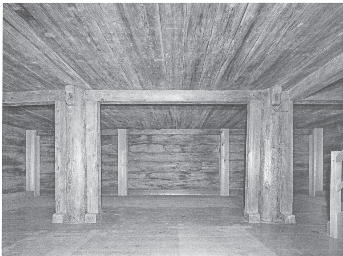
100 ガラス戸付陳列棚解体後の北倉一階北面 南より見る。一階の外に面した壁面には、雨染みの痕跡が多い。
