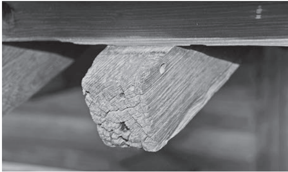
図147 当初飛檐垂木の鼻先 天端風蝕痕により当初の茅負の位置がわかる。
