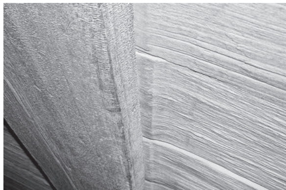
図137 中倉壁板の風蝕の様子（西面北側柱際）
