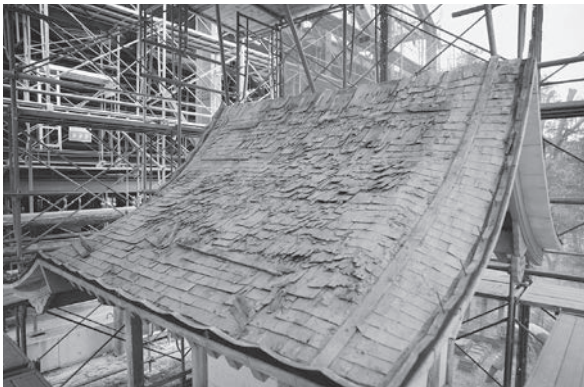
図296 土居葺の破損状況
