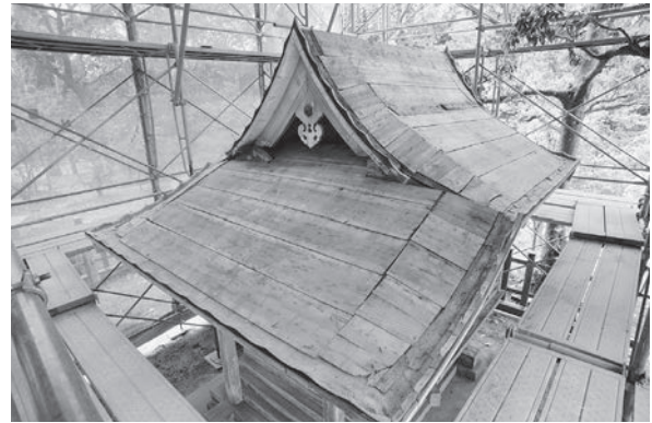
図288 野地板の状況
