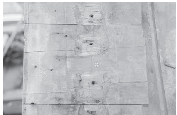
図297 裏甲天端の状況
