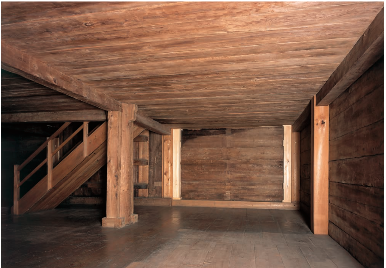
8 補強工事完了時 北倉内部一階東面南寄りの壁面焼け焦げ跡（ガラス戸付陳列棚組立前）
